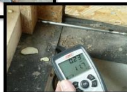
Fuite lisse basse jonction
