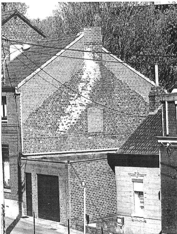
Fig.1 – Traces de condensation dans une cheminée construite contre ou dans l'épaisseur d'un mur extérieur.
